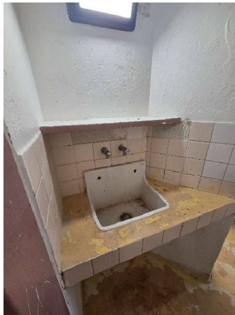
Douche et lavabo collectifs du Quartier « mineurs »
