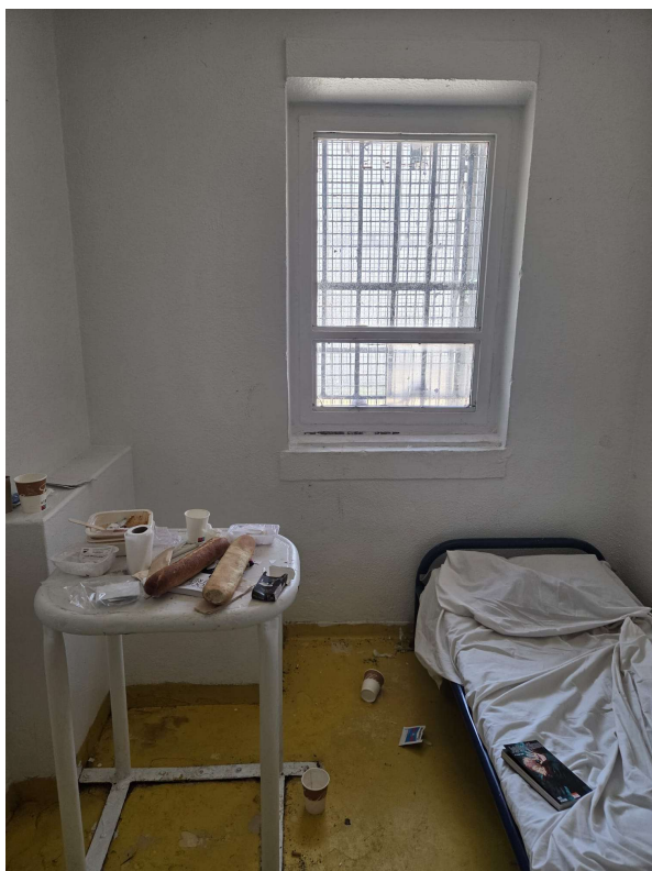
Visite d'une cellule occupée : sol dégradé
